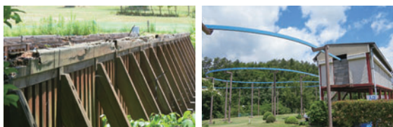
補修を待つ施設
